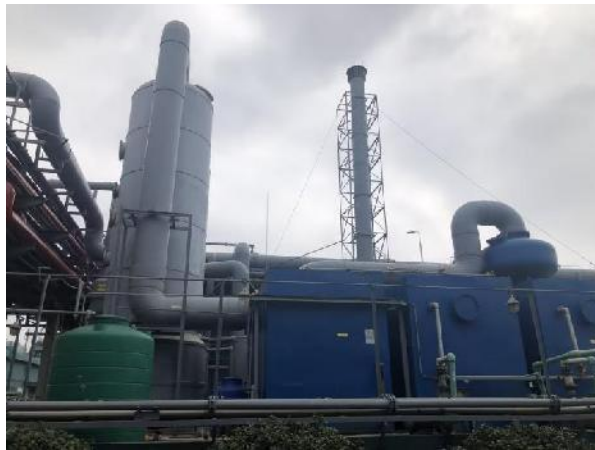
废水站处理设施
