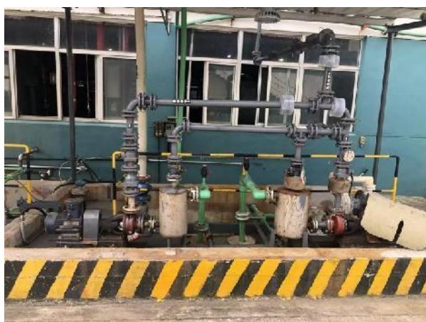
高浓废水收集池
