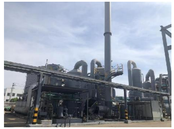
RTO废气处理设施
