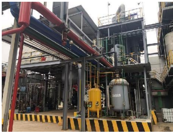
多效蒸馏设施
