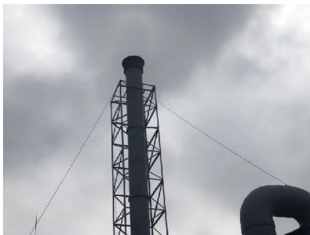
废水站排放筒
